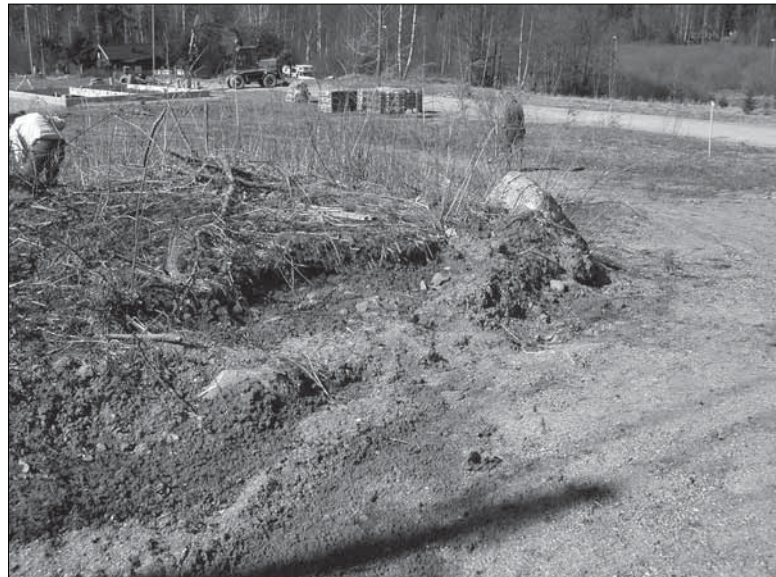
Figur 7. Den av schaktarbeten skadade skärvstenshögen RAÄ130. Bilden är tagen från SÖ. Foto: Lars Norberg 2004, Sörmlands museum.
