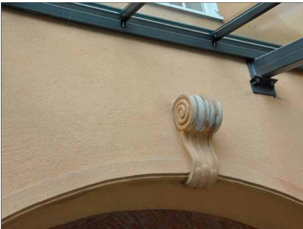
8. Dekorativ utsmyckning i form av volut, placerad vid valvbågens slutsten. Bakom sprutputsen framträder en slätputsad yta. (SLM 2015-979)
