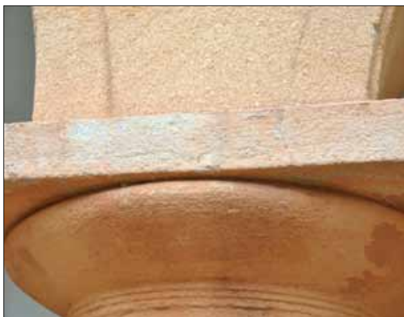
14. Detalj av kolonnens kapital i arkaden, hus 1. Vid skrapning framträder en ljusare putsad yta. (SLM 2015-985)
