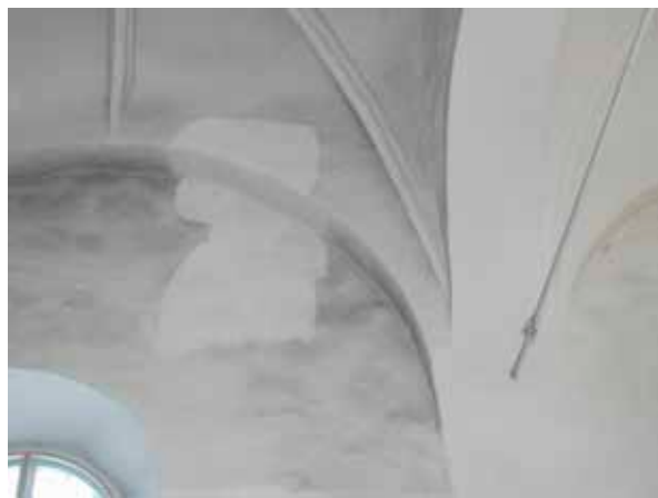
Skillnad syns mellan rengjort och smutsigt parti.
