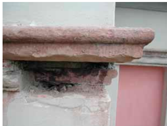
På den övre listan var ett av hörnen kraftigt eroderat. Här syns lågerhuggning/refflor i stenen och profilerna. Sammanlagt lagades fyra hörn.
