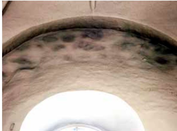
Väggpartierna ovanför fönstren var hårt nedsmutsade.
