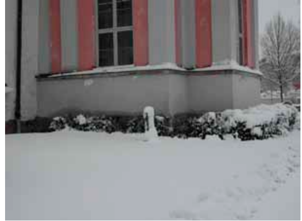
Snö och fukt samlas på den vinkelräta listen mot sockeln på gravkoret. Foto vintern 2004/2005.
