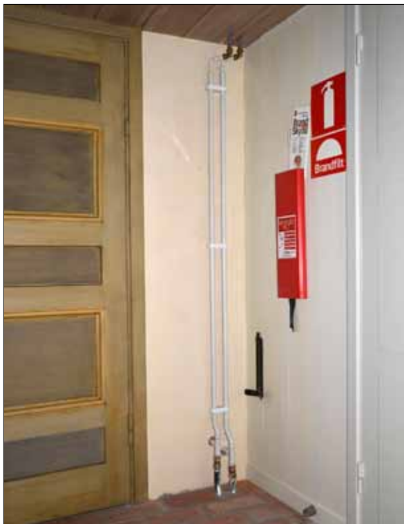
16 Synlig rördragning från tornets bottenvåning upp till orgelläktaren (SIm D12-0368).
