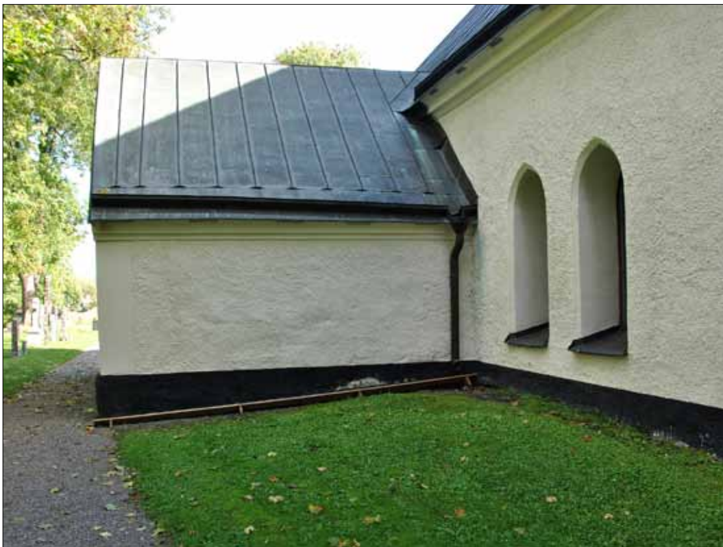
3 Hörnet mellan sakristians västra och långhusets norra fasader i samband med förbesiktningen i september 2010 (Slm D12-0355).
