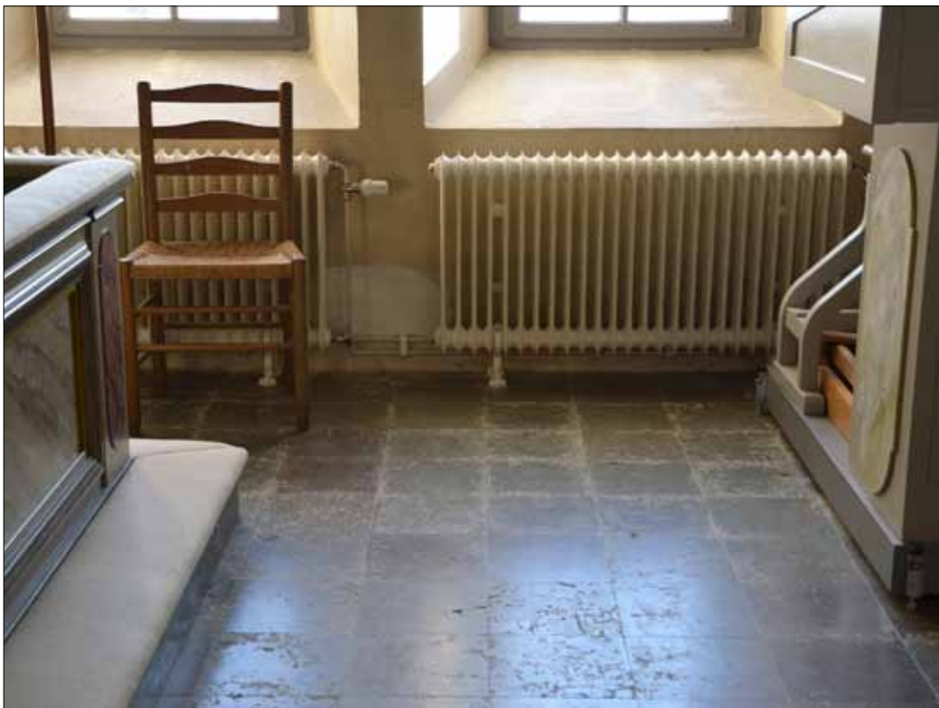
14 Sektionsradiatorerna i koret monterades inte på vägg utan ställdes på fötter som limmades fast i golvet (Slm D12-0366).
