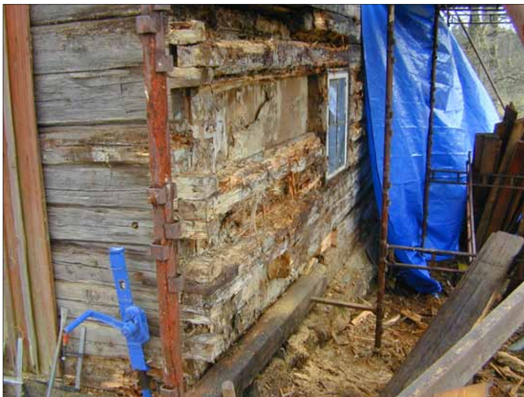
14 Timmerstommen öster om norra fasadens fönster var i mycket dåligt skick (Slm D12-0289).
