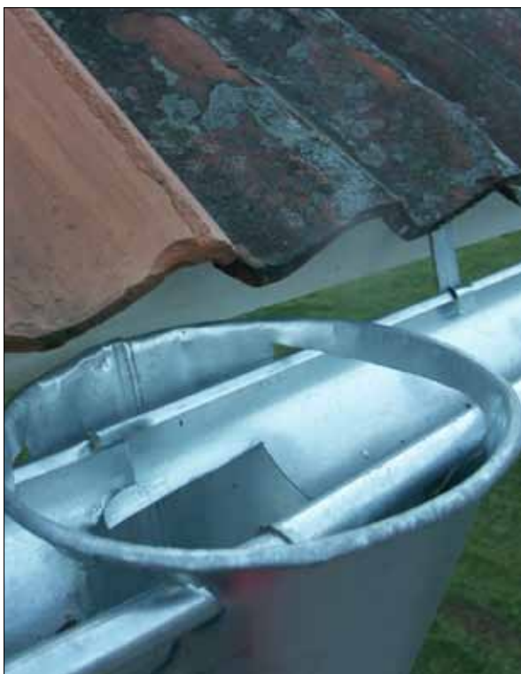
11 Vattkuporna förstärktes med en galvaniserad stål-tråd vid ovankanten. Slutbesiktningen i december 2004 (Slm D12-0275).
