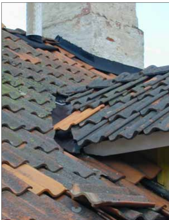
12 Rännan vid södra takfallet, augusti 2004 (Slm D12-0276).
