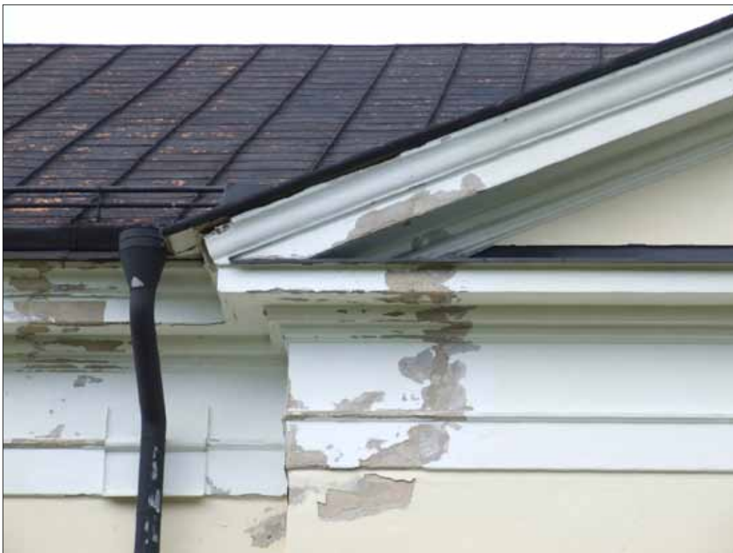
10 Västra takfotsdelen på södra fasadens mittrisalit med skador i putsen. Fotografi Kjell Taawo, Sörmlands museum (Slm D12-0248).
