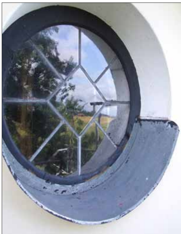
13 Mittrisalitens fönsterbåge på norra fasaden före åtgärder. Fotografi Kjell Taawo, Sörmlands museum (Slm D12-0251).
