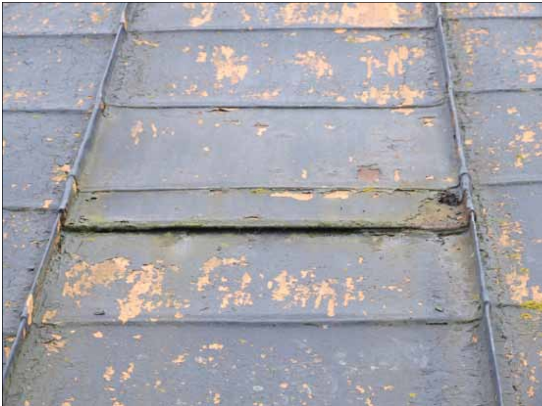
7 Detalj av en äldre plåtlagning på norra takfallet (Slm D12-0245).
