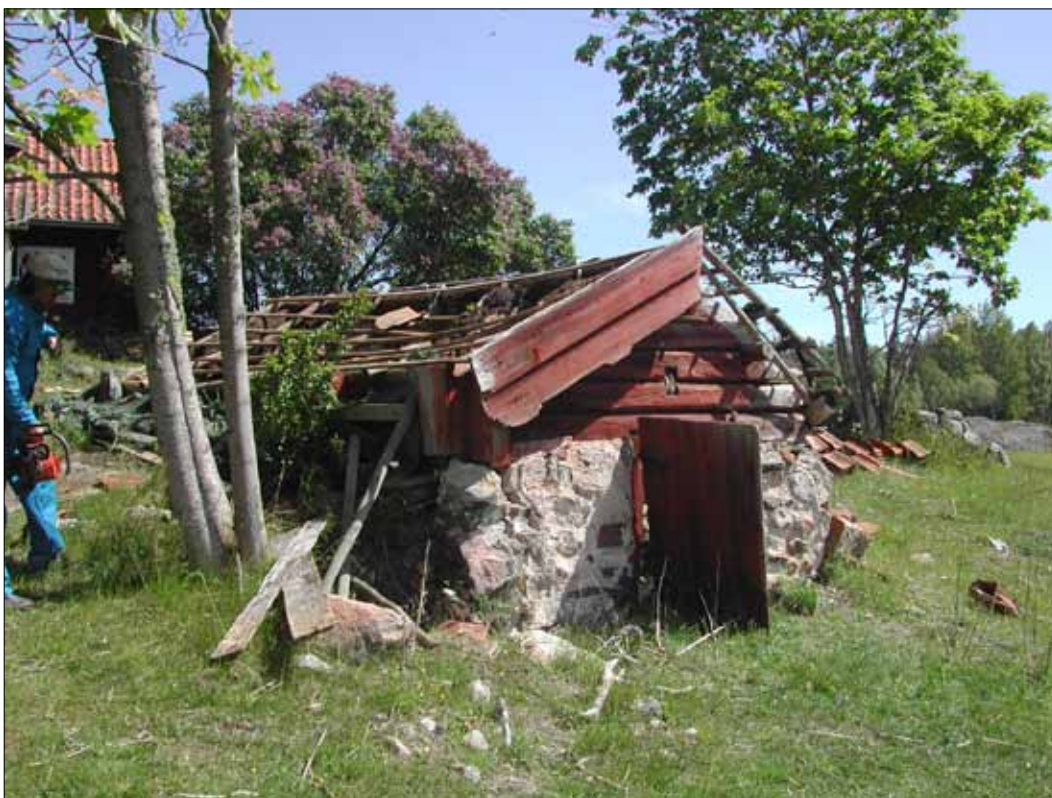
3 Jordkällaren sedd från nordväst före åtgärder den 28 maj 2002. Träd växte nära jordkällaren och muren var delvis rasad (Slm D12-0431).
