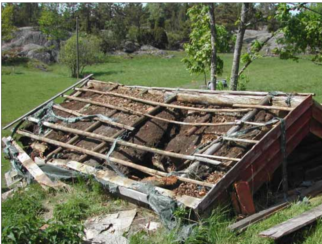
4 Jordkällaren före åtgärder den 28 maj 2002. Takteget är bortplockat. Underliggande torvlager har rasat in (Slm D12-0433).
