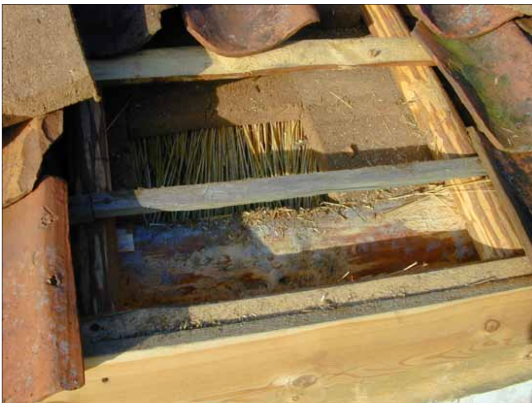
13 Detalj av taket efter avslutade takarbeten. Under torven ligger ett lager med halm och mossa (Slm D12-0441).
