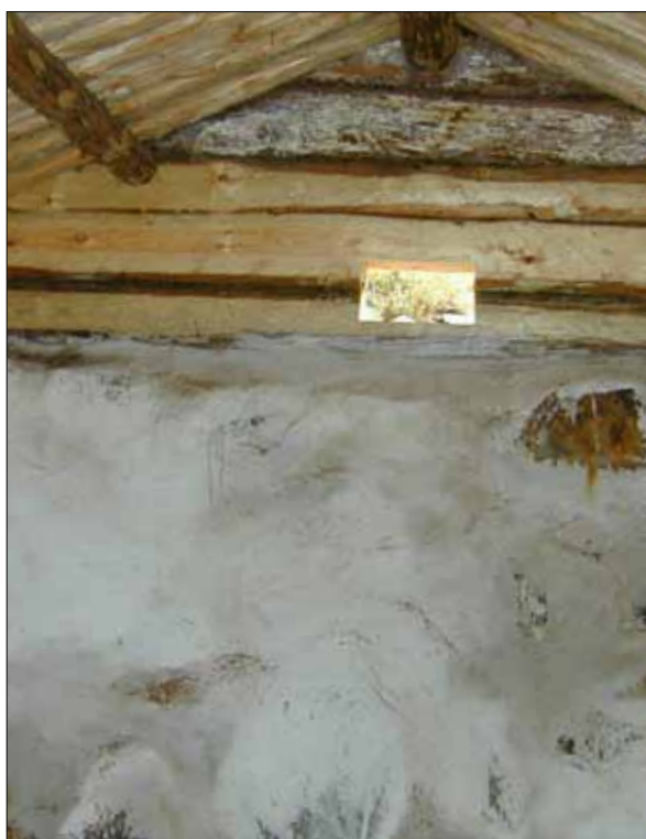
11 Nya stockar utformades på samma sätt som tidigare. Den rektangulära öppningen rekonstruerades. (Slm D12-0439).
