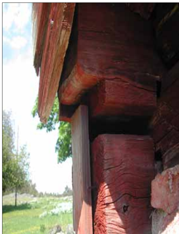
8 Detalj av sydvästra hammarbandet som hade en skuren avrundning av kanten. Före åtgärd (Slm D12-0436).
