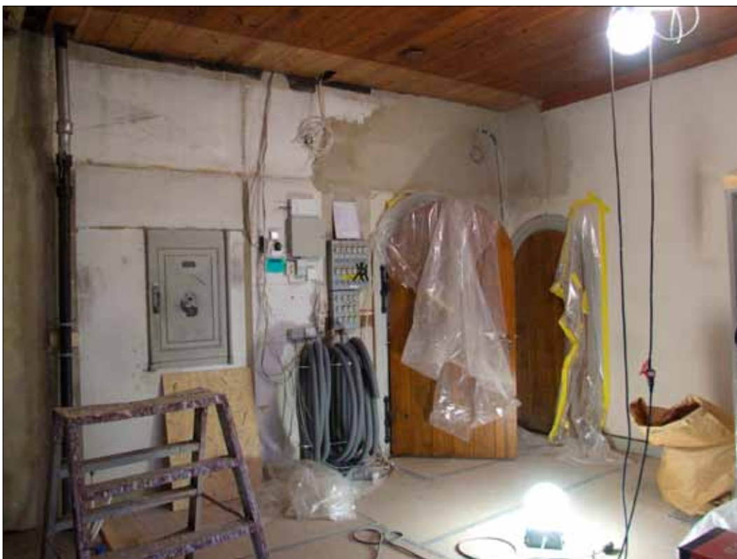
24 Sakristian sedd mot söder under arbeten. Elledningarna drogs ned till källaren. Vissa putslagningar av väggarna utfördes. (Slm D12-0179).
