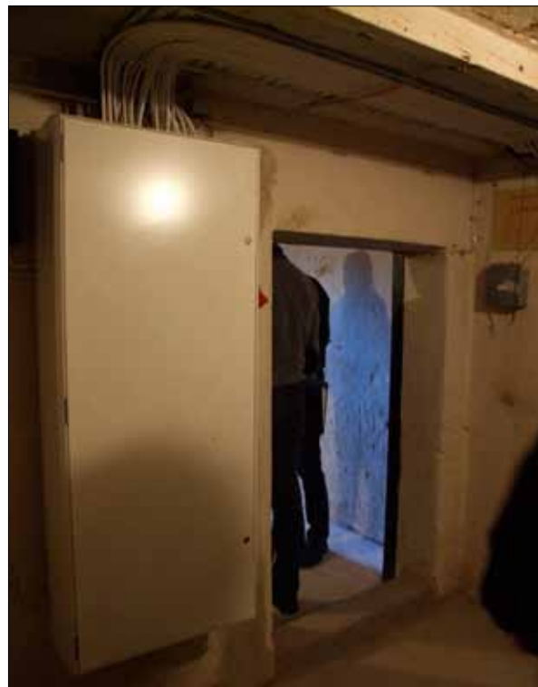
21 Elcentralen placerades i källaren (Slm D12-0176).
