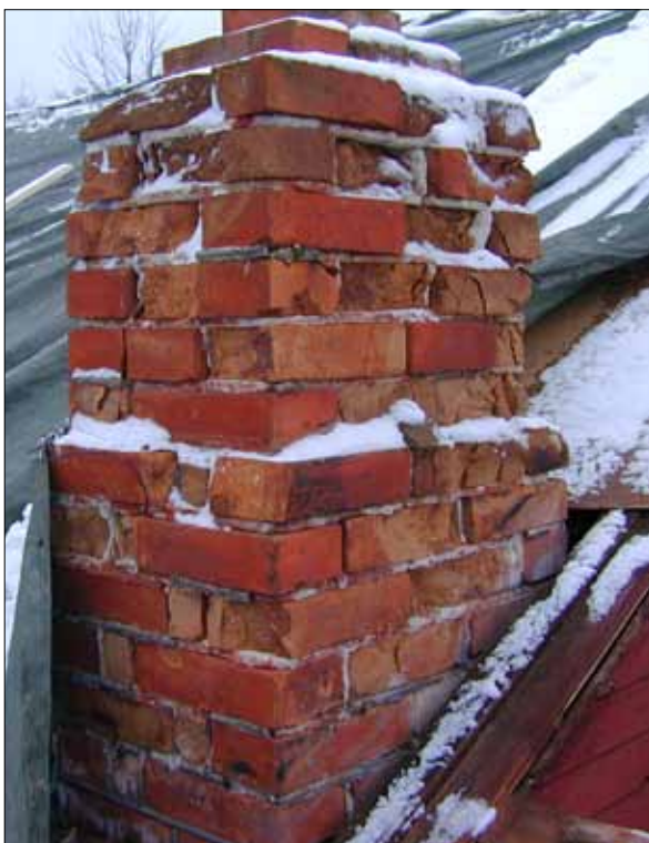
8 Skorstenen var i mycket dåligt skick före arbetena startade, november 2002 (Slm D12-0387).
