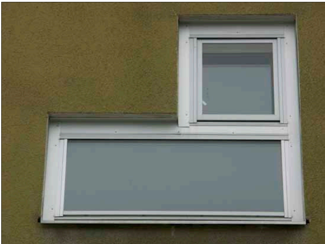
Plåtindustrins fönster som även kan ses på de långa fönsterbanden i sydost.
