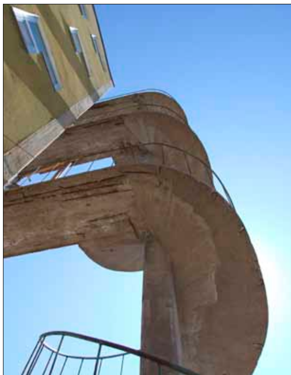
Spiraltrappan underifrån före åtgärder.
