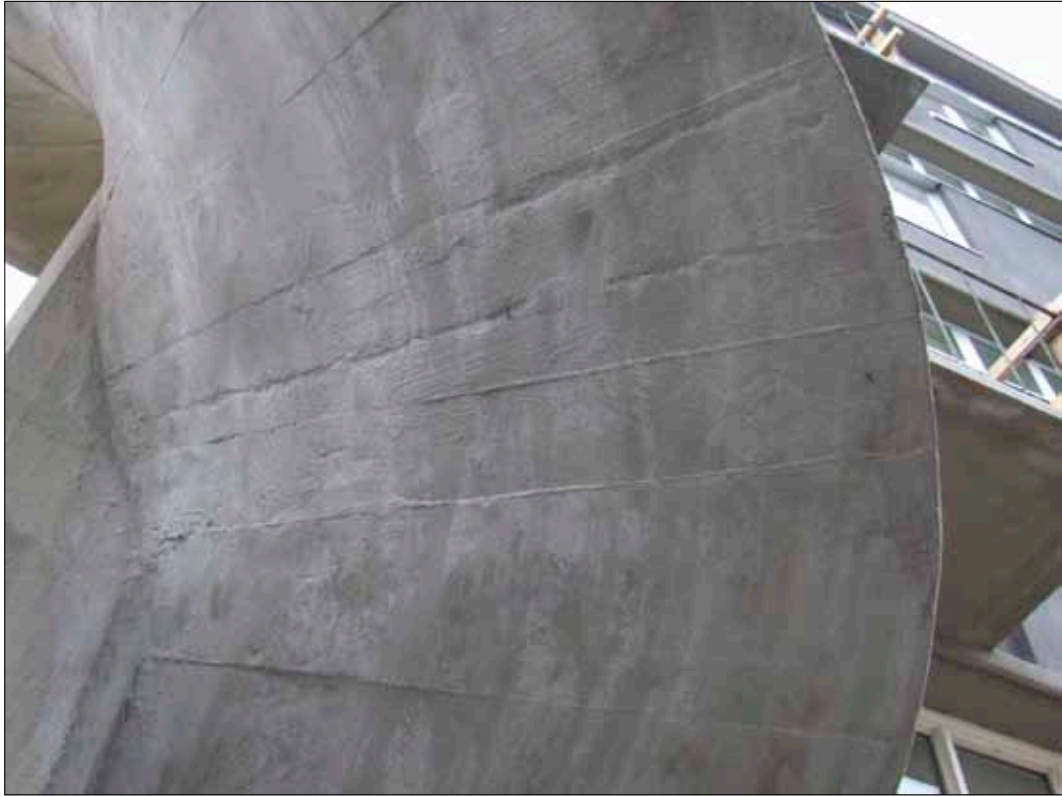
Den ursprungliga brädgjutningsformen under trappan finns kvar till vissa delar men ytan är något utslätad.
