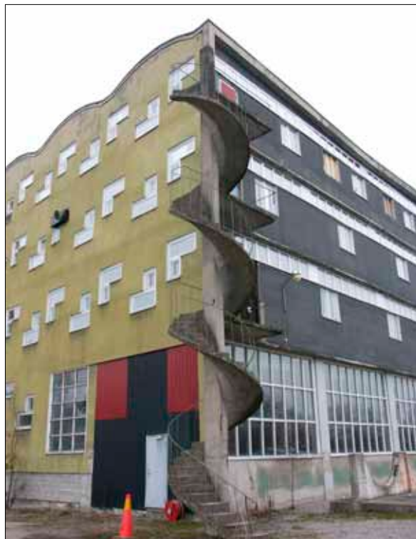
Utrymningstrappan i det södra fabriks hörnet var kraftigt eroderad och kunde inte användas.
