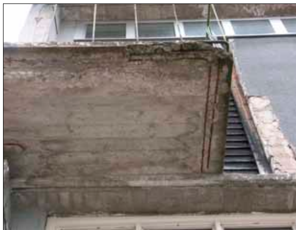
Betongtrappans undersida med vittrad betong och synliga, rostiga armeringsjärn.
