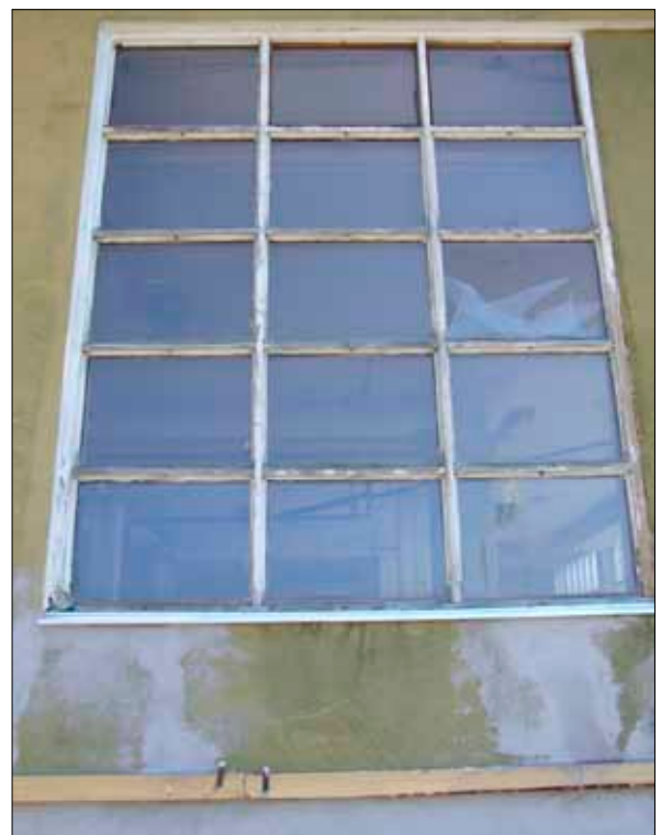
Dessa fönster i bottenvåningen är av stor betydelse och bör ges en ordentlig översyn, kittas om och målas med linoljefärg.
