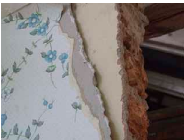
Ljusgul kulör på puts bakom gipskiva i det södra sovrummet i våning två. Rosa kulör skymtar under den gula putsen.
