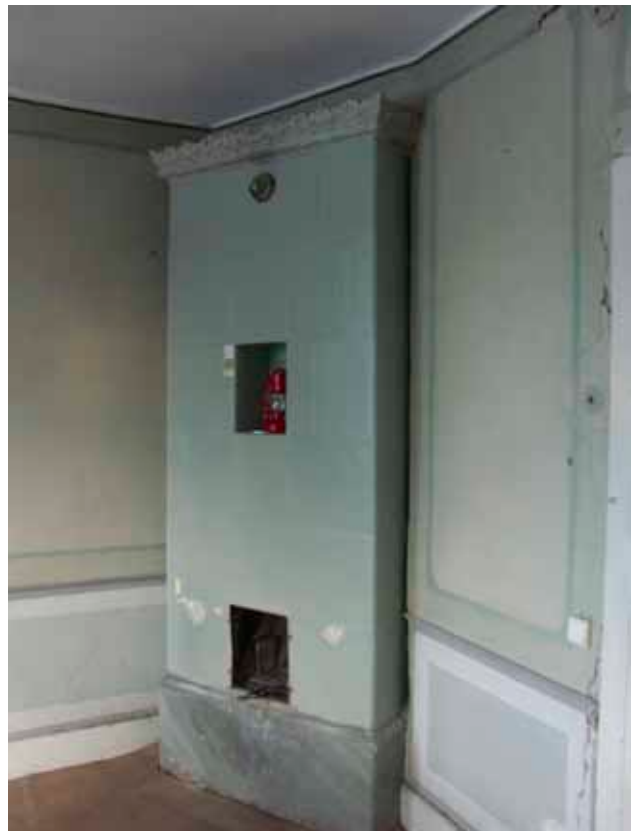
Den ursprungliga kakelugnen i matsalen, vilken dömdes ut och har ersatts. Mått: höjd 2 m + sockel 0,40 m, bredd 0,96 m och djup 0,50 m. Den förvaras på gården.
