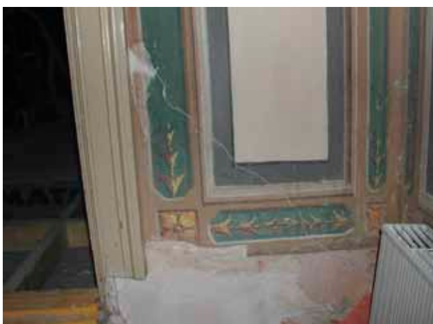
I salongen har skador på väggmåleriet uppstått. Konserveringsarbete har utförts under 2007 av målerikonserverator Gabor Pasztor.
