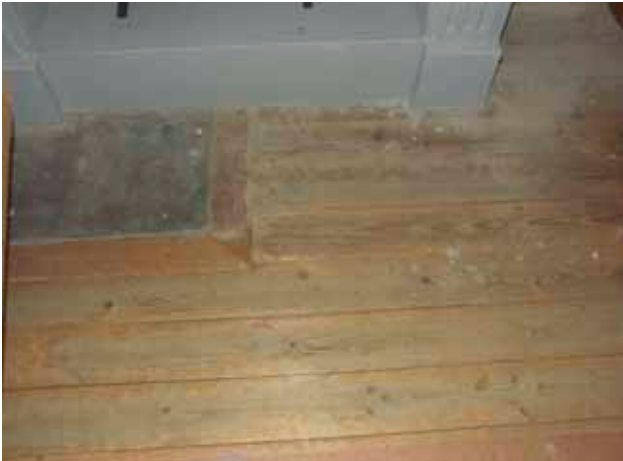
Salongens brädgolv vid den år 2005 nytillkomna spisen, vilken nu har tagits bort. Golvbrädorna har därför fått skarvas i. Väggen mot matsalen underbyggdes för att hindra sprickor.
