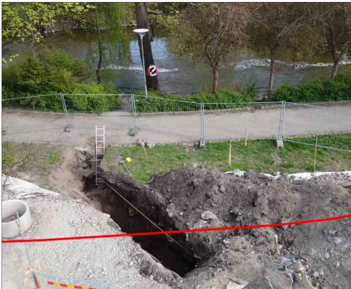
Figur 5. Det undersökta schaktet 1 med det medeltida bryggfundamentet (A1) i botten, 1,6 meter under markytan. Den tänkta dåtida standlinjen vid mitten av 1200-talet är markerad med röd linje. Foto: Björn Pettersson 2014, Sörmlands museum.
