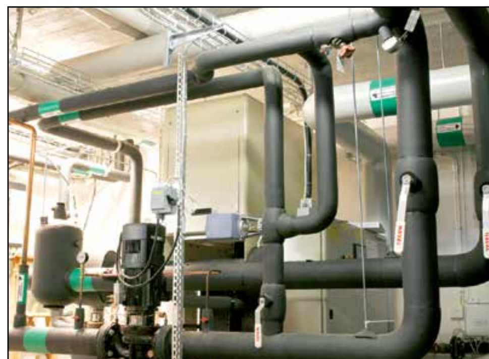
Värmepumpen i bergvärmeanläggningen på Frejaskolan.
