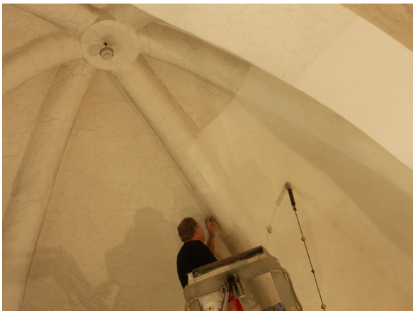
Murare Benny Karlsson arbetar från skylift i koret med putsrengöring. Stor skillnad syns mellan rent och smutsigt fält.
