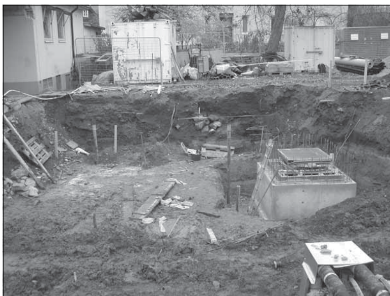
Figur 3. Översikt mot norr över det öppnade schaktet och pågående byggnationsarbeten inom Kvarteret Munkbacken 4 i Strängnäs. I bakgrunden syns den norra schaktväggen samt resterna efter den stengrund (fas 4) som iaktogs centralt i sektionen. Foto: Lars Norberg, Sörmlands museum, 2003.
